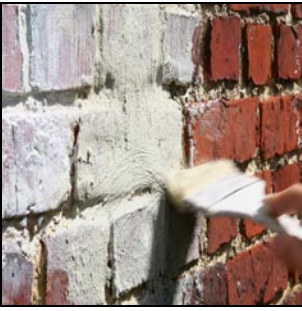
Kaleien op bakstenen muur
